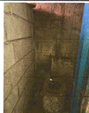
Foto 4: Estado de servicios sanitarios para estudiantes en pésimas condiciones
