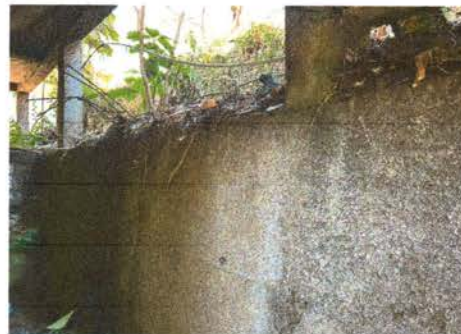
Foto 2: perímetro norte del establecimiento en condiciones vulnerables a desastres naturales (lluvias, inundaciones)
