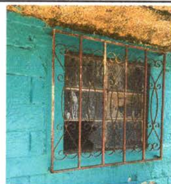
Foto 6: Ventanal de la cocina en estado deficiente.
