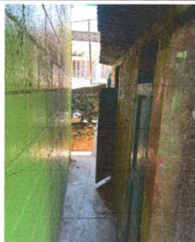
Foto 3: Servicios Sanitarios en mala calidad
